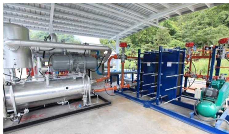
清水地熱區雙循環地熱發電示範系統
